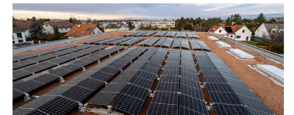
Photovoltaikanlage auf dem Dach des BILLA Marktes in der Pilotengasse.
